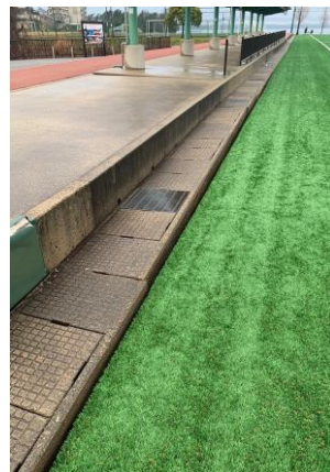
写真① ② サッカーコートA陥没
